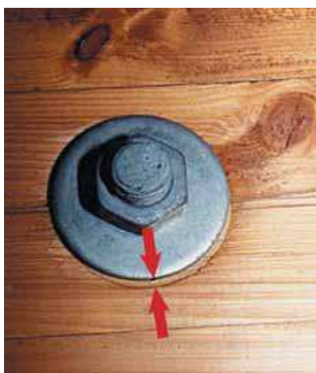
Figure 19 - Déplacement du boulon d'assemblage.
