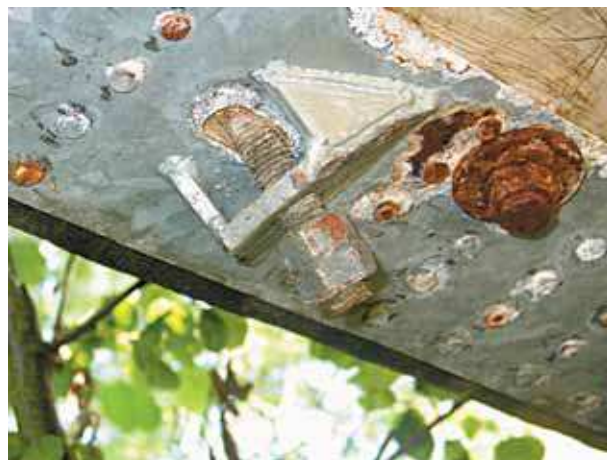
Figure 66 - Oxydation d'organes métalliques.
