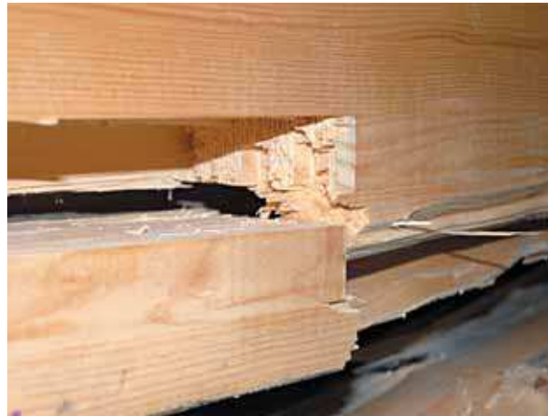
Figure 34 - Rupture complète par perte de section résistante.
