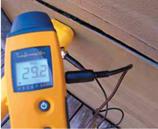
Figure 13 - Fente très ouverte due au retrait du bois et induisant une humidité localement élevée.
