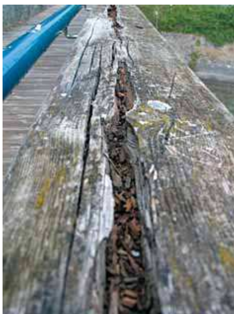
Figure 36 - Surface de bois non protégée : fentes de retrait, infiltration d'eau, développement fongique.
