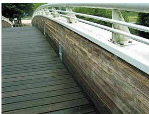
Figure 74 - Dégradation des lasures.
