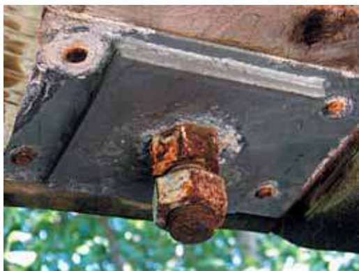
Figure 46 - Corrosion des boulons et mauvais serrage du contre écrou.
