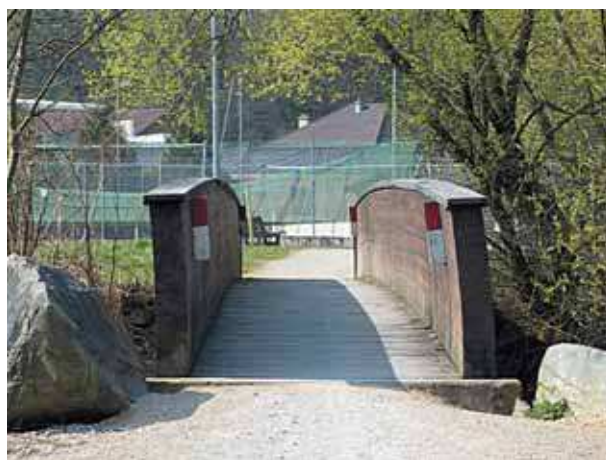
Figure 61 - Déformations latérales de poutres en bois lamellé collé.
