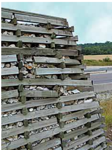
Figure 22 - Désorganisation d'un mur de soutènement
