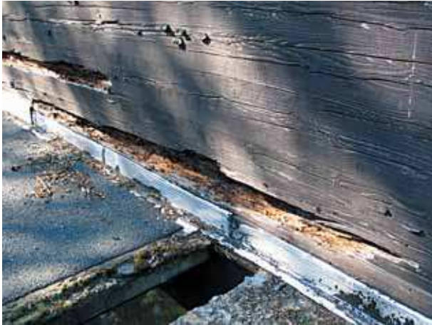
Figure 39 - Zones pourries allant jusqu'à la ruine du platelage (détail de la photo 38).
