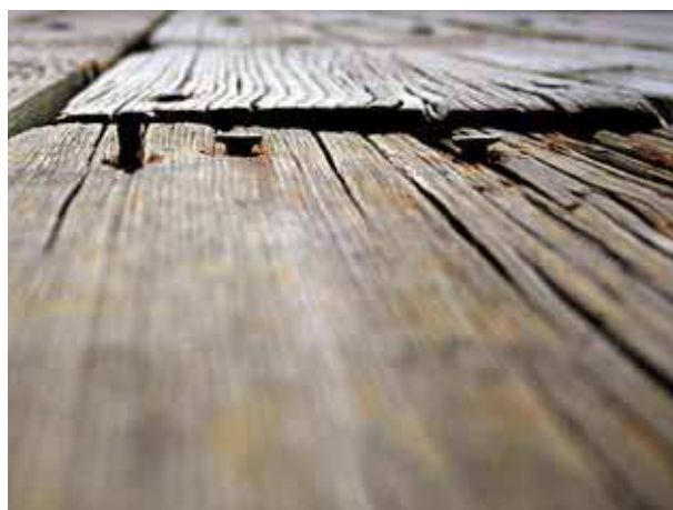
Figure 24 - Déclouement du platelage suite aux vibrations.
