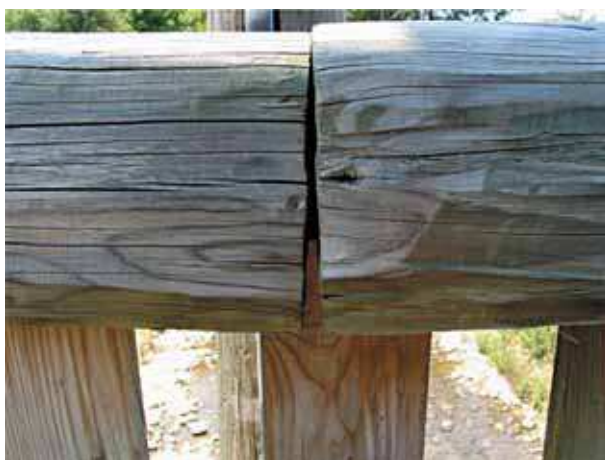
Figure 63 - Désalignement de lisses d'une main courante.
