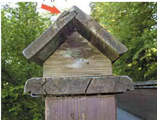
Figure 45 - Assemblage bois sur bois piégeant l'eau.
