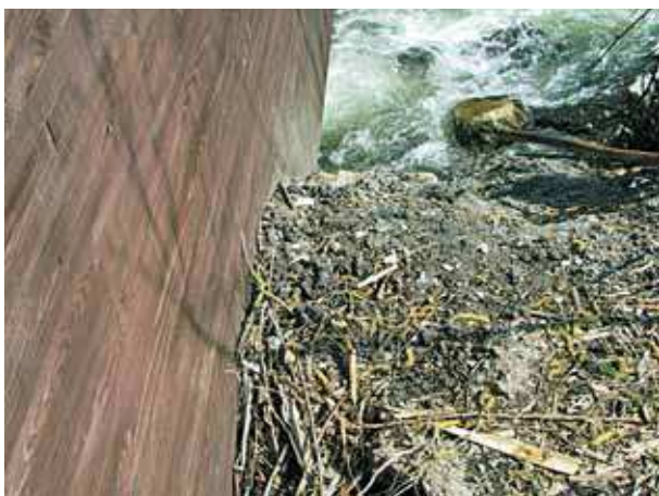
Figure 43 - Accumulation de terre au contact du bois.
