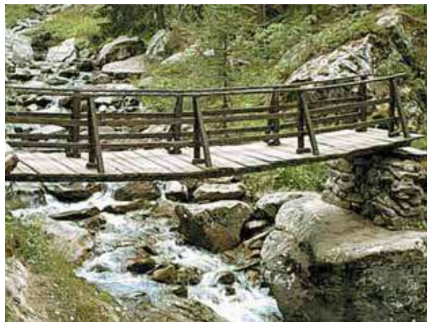
Figure 60 - Passerelle présentant une flèche importante.
