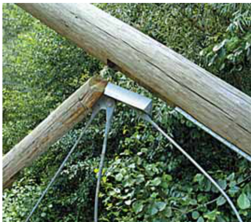
Figure 21 - Rupture d'un assemblage.
