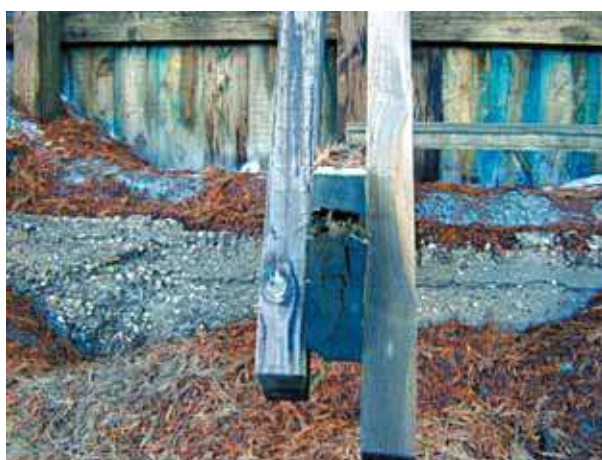
Figure 64 - Rupture par excès de traction transversale.
