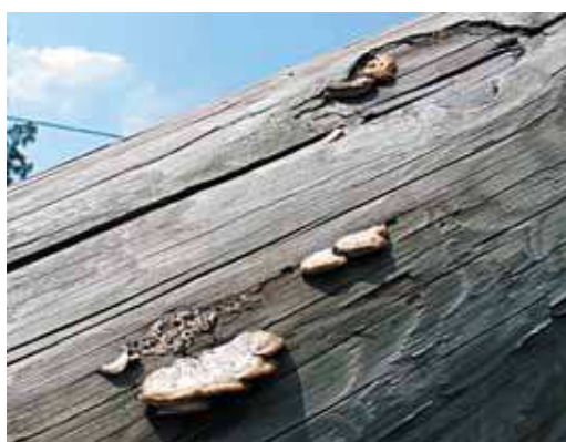
Figure 37 - Présences de champignons apparents témoins d'une dégradation avancée.
