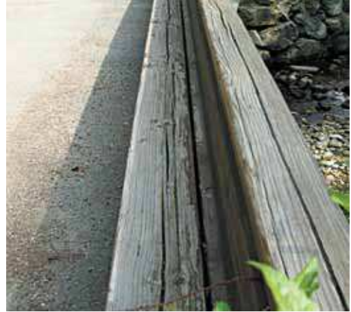
Figure 15 - Fentes de retrait sur les lisses d'un garde-corps, créant ainsi des pièges à eau.
