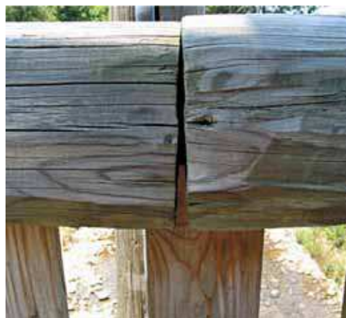
Figure 35 - Déformations excessives signe d'un affaiblissement possible de la structure.
