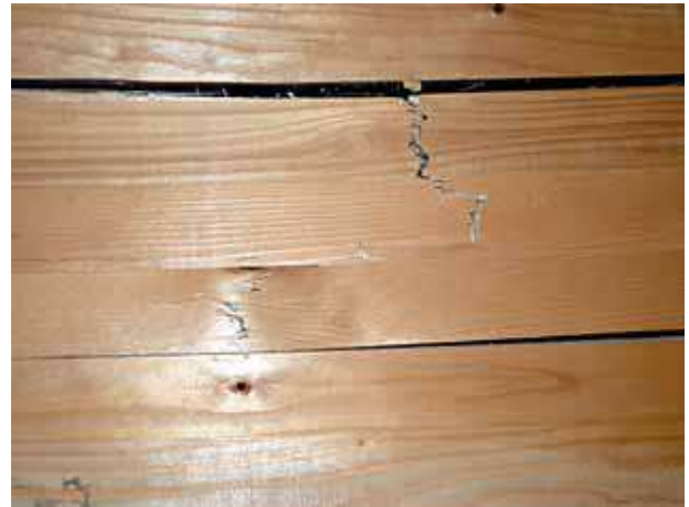
Figure 33 - Propagation de la fissure de traction axiale et bifurcation dans le sens des fibres.
