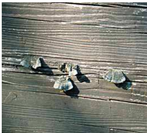
Figure 53 - Champignons apparents témoins de dégradation avancée.
