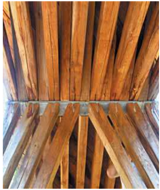
Figure 16 - Bois fendu sous chaussée.
