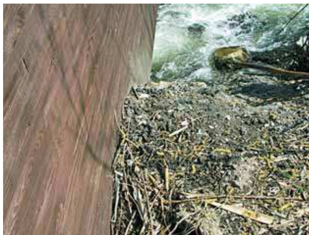
Figure 70 - Présence d'un milieu humide (terre) au contact du bois.
