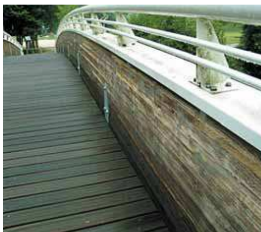
Figure 51 - Dégradation d'une lasure par farinage.
