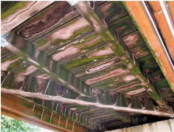
Figure 54 - Zones sombres témoins d'humidification localement élevée. La mousse verte est un lichen.
