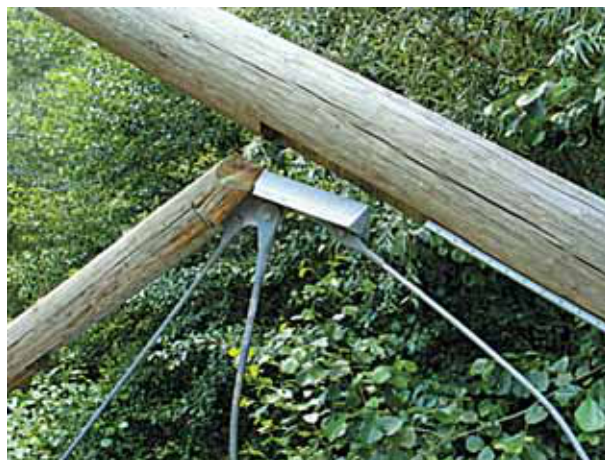
Figure 68 - Rupture d'un assemblage.
