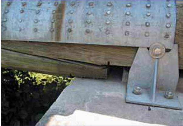
Figure 28 - Rupture du bois par traction transversale.
